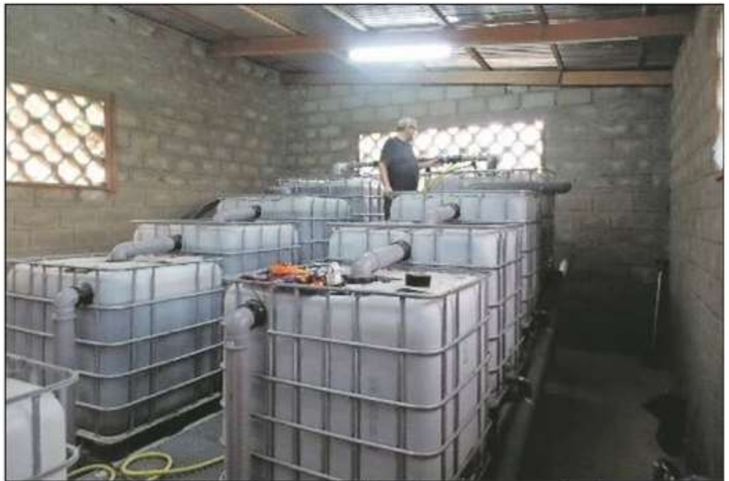
Herzblut und viel Geld stecken in der Wasserfilteranlage, die Rastatter für das Krankenhaus in Kamerun gebaut haben. Sie zu betreiben, ist momentan zu gefährlich.
