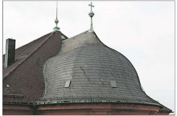
Die zwiebelartig geschwungene Form des Dachs über dem Altarraum macht die Arbeiten an St. Alexander zu einer Herausforderung.
