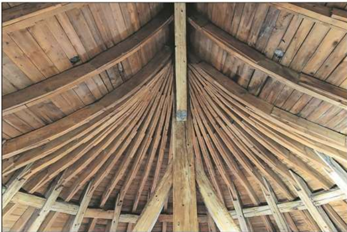
Eine handwerkliche Meisterleistung ist die innere Konstruktion des Dachs. Die hölzernen Sparren sollen erhalten bleiben, die Umschalung wird erneuert.
